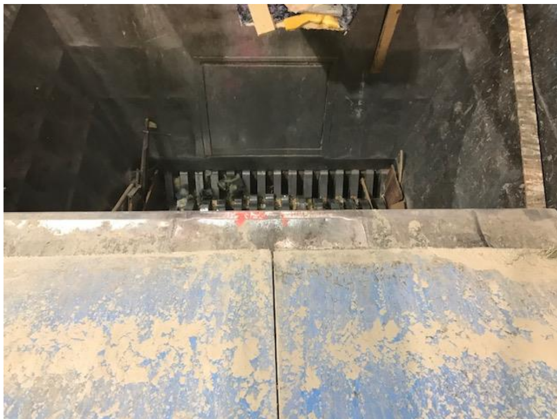
Obr.5 pohled do násypky drtiče DRU 2400 s drticími segmenty
